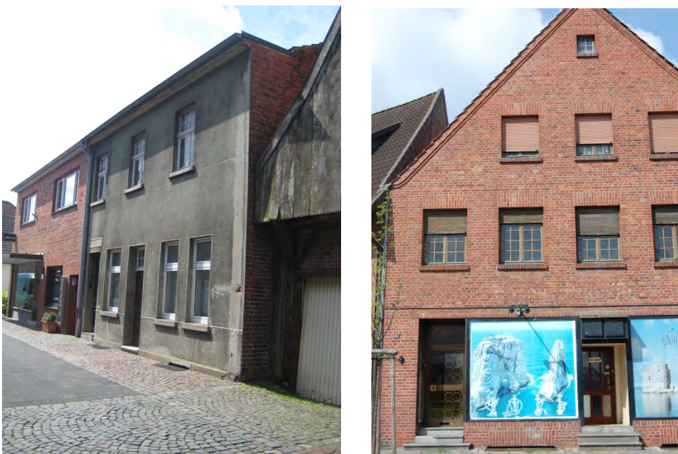
Abbildung 7: Gebäude mit erheblichen Mängeln
