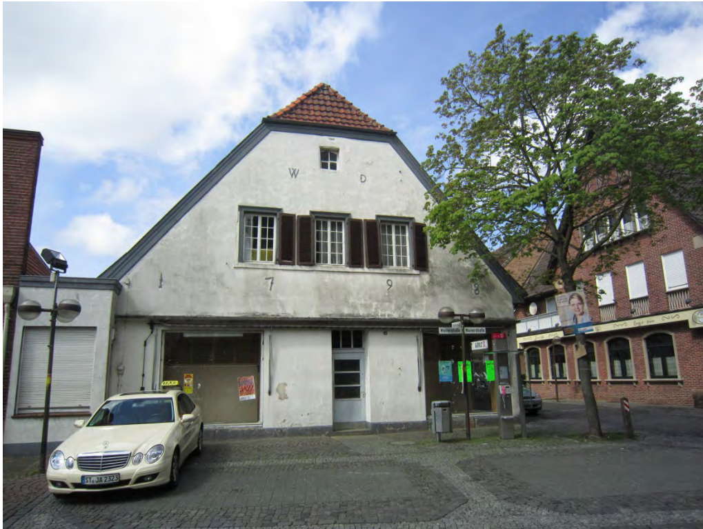
Abbildung 8: Leerstehendes, sanierungsbedürftiges Gebäude "Hues"
